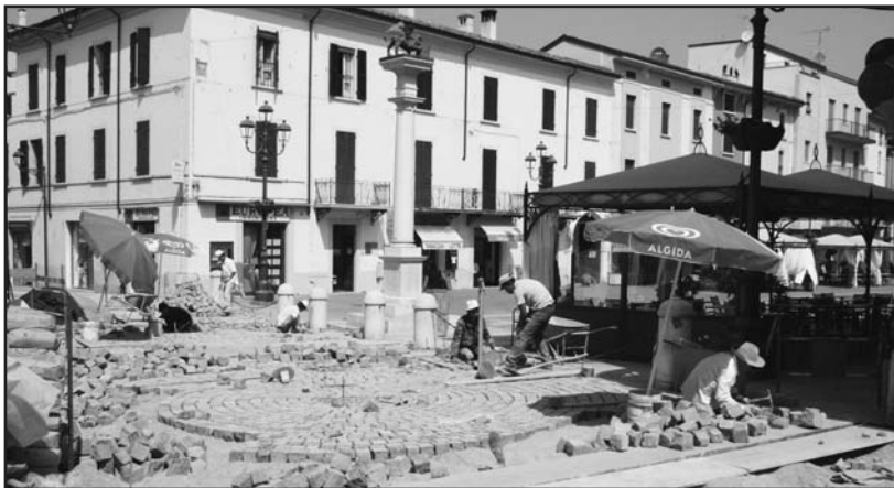
Stranieri al lavoro per la seconda sostituzione della pavimentazione di via Martiri della Libertà. (Foto Mor)
